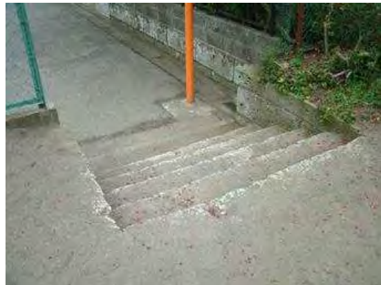
手すりのない階段
