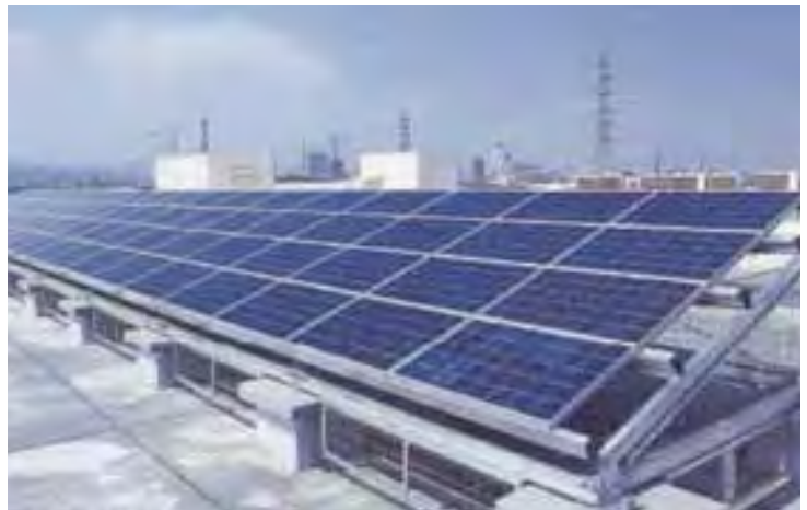
太陽光発電設備
