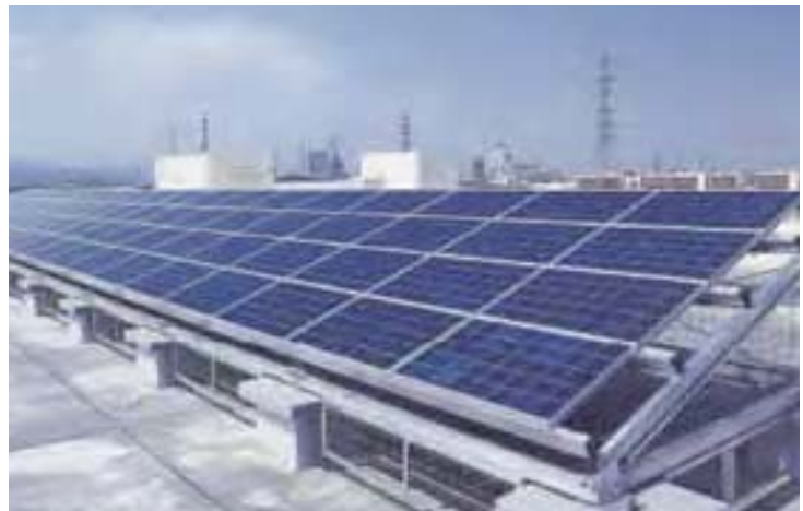
太陽光発電設備
