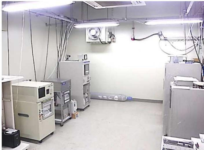
市役所測定局(一般環境大気測定局)内部
