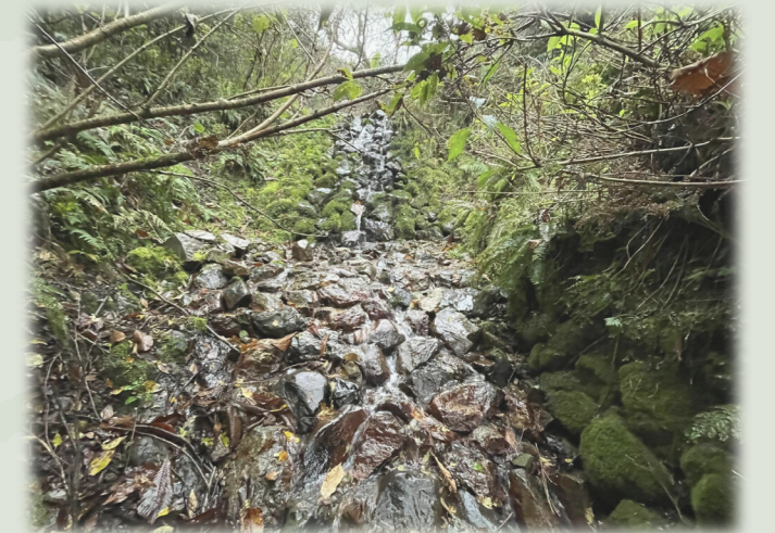
アカタン砂防堰堤群
