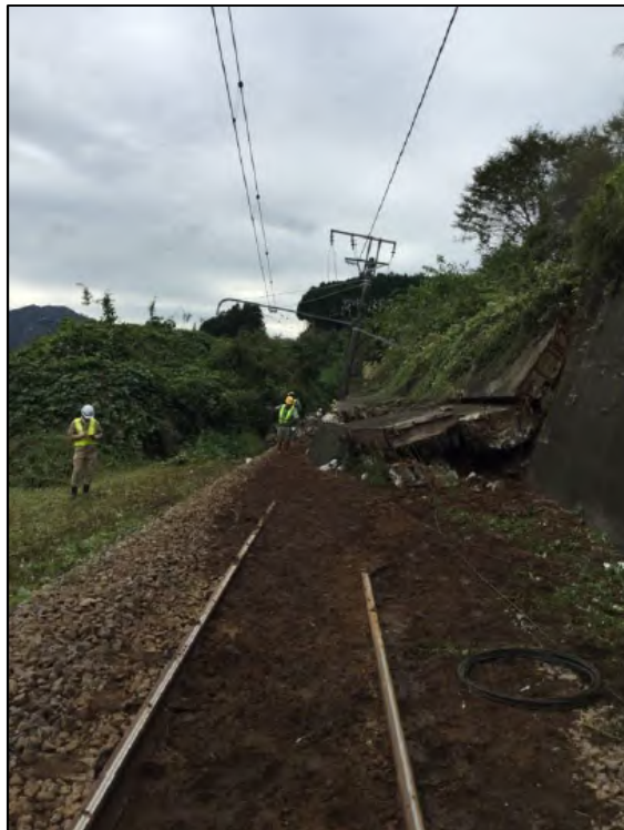
高尾～相模湖間(上り線)での土砂流入及びコンクリート壁崩落に係る復旧作業(10月15日(火)13時時点)
