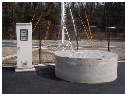
地下水揚水井
