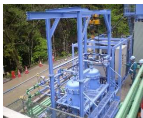
トンネル工事濁水
