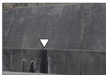
地下水の流出
