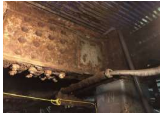
図4.1-1 建築構造部の劣化状況 (飛灰処理設備)
