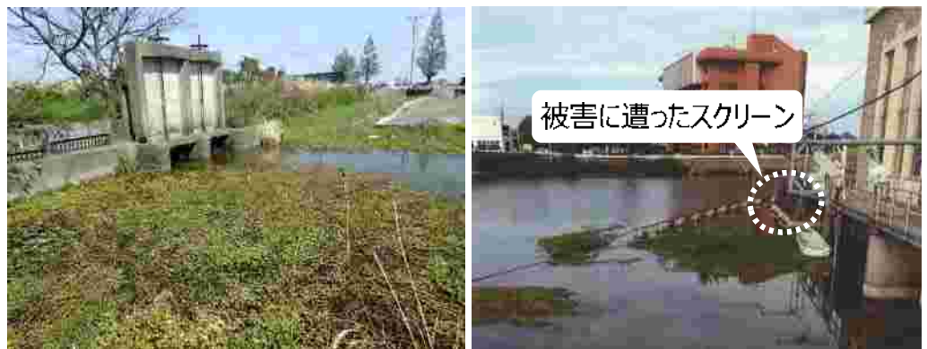
水路を閉塞し、取水・排水の障害となる 排水機場のスクリーン周辺に溜まり目詰まり
