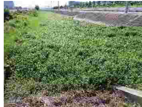
水路 (コンクリートブロックライニング) での大量繁茂
