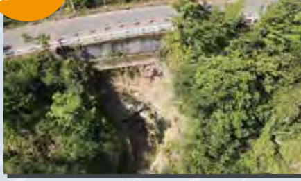
道路下の斜面が崩落
