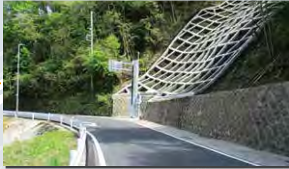
ガードレールを設置し、のり面をコンクリートで覆い本復旧完了
