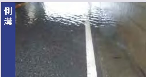
側溝蓋が外れていることに気付かず、人や自転車などが転倒する恐れあり
